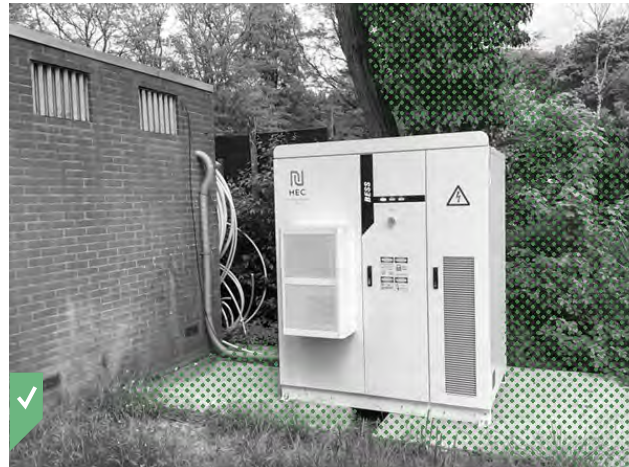
Trafovoorziening op betonplaten geplaatst. De naastgelegen beplanting is inheems.
