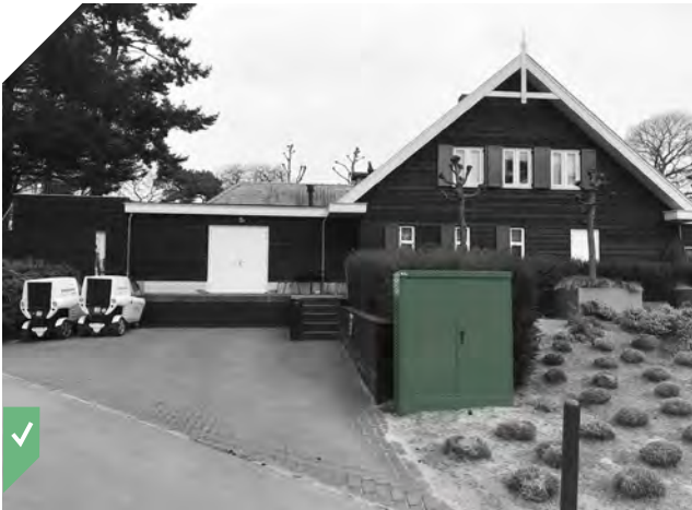
Nutsvoorziening, goed gesloten en geplaatst op zand, vrij van publieke ruimten, goed bereikbaar.
